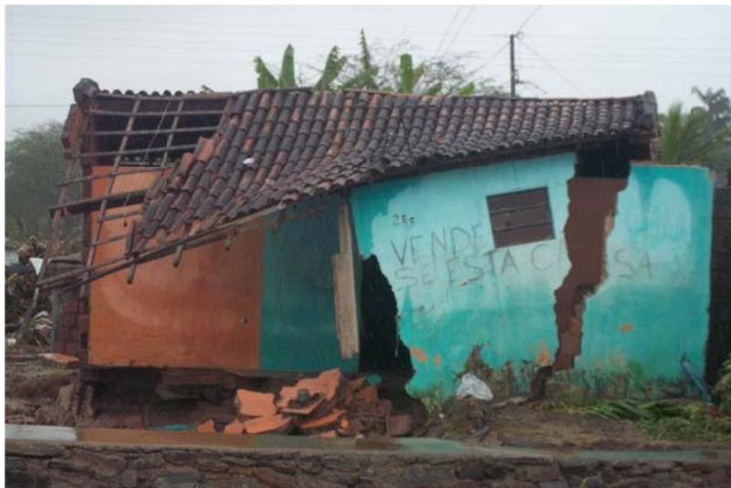
Figura 1: Casa destruída após desastre na comunidade do Mutirão CG/PB
